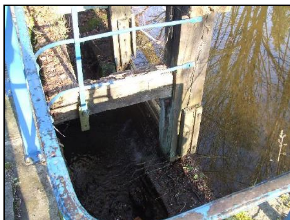
Surverse canal de la BTT (sur ruisseau R1) qui matérialise le départ du ruisseau 2
